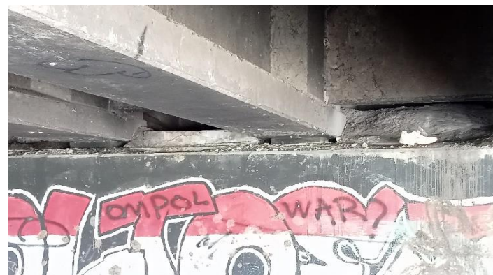
KONDISI PERLETAKAN ELASTOMER
