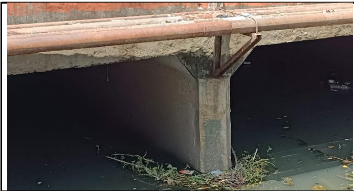
KONDISI PILAR DAN PELAT JEMBATAN RUSAK RINGAN
