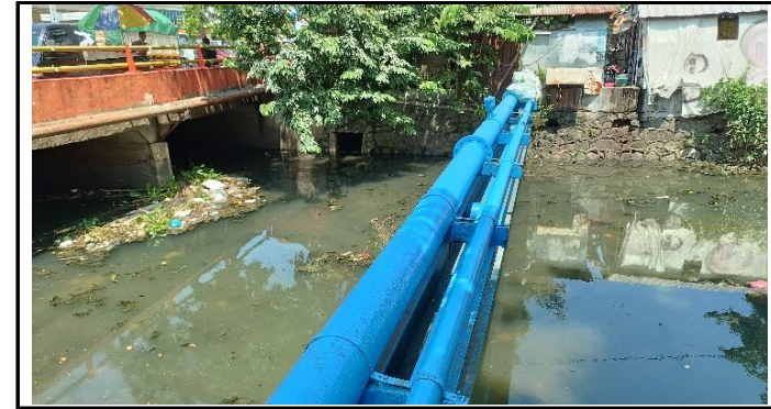
KONDISI UTILITAS PIPA AIR MINUM MASIH BAIK
