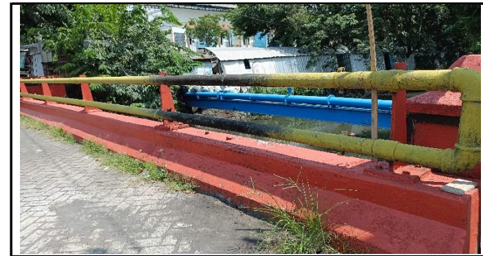
KONDISI SANDARAN HORIZONTAL HANGUS BEKAS TERBAKAR
