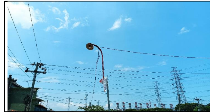
SISTEM PENERANGAN JEMBATAN
