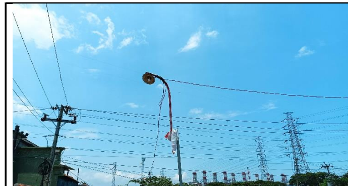
SISTEM PENERANGAN JEMBATAN
