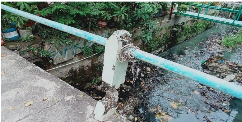
TIANG SANDARAN PECAH
