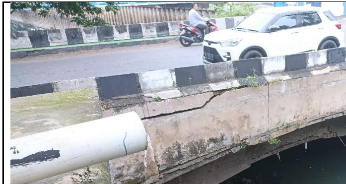
KONDISI PELAT LANTAI DAN SANDARAN RETAK DAN KEROPOS
