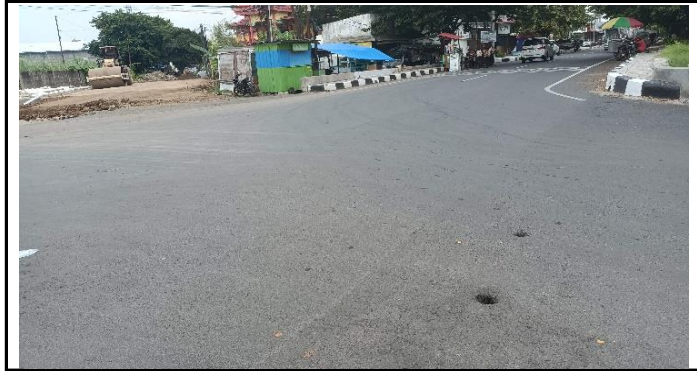
KONDISI PIPA CUCURAN DRAINASE
