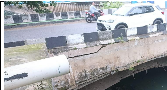
KONDISI PELAT LANTAI DAN SANDARAN RETAK DAN KEROPOS
