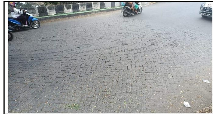
KONDISI LAPISAN PERMUKAAN LANTAI BERGELOMBANG
