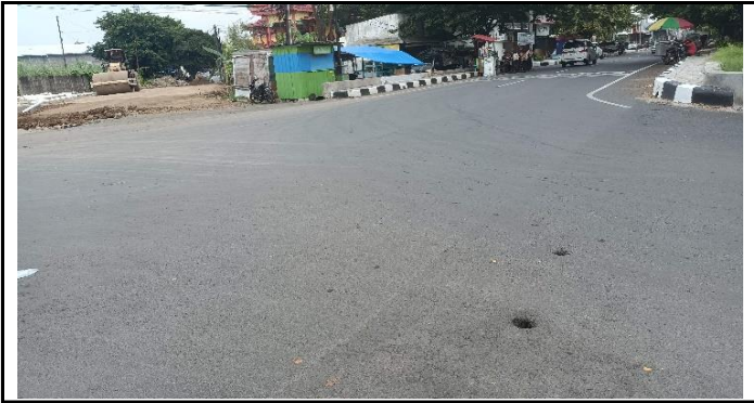
KONDISI PIPA CUCURAN DRAINASE
