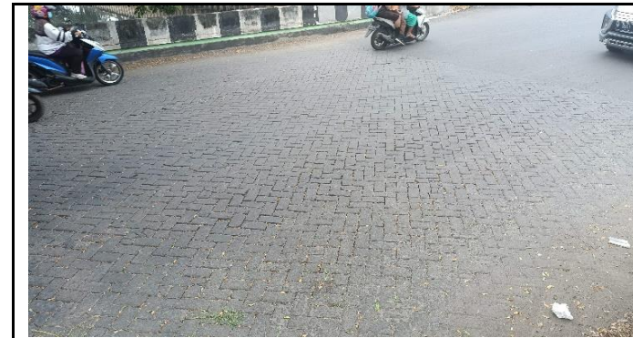
KONDISI LAPISAN PERMUKAAN LANTAI BERGELOMBANG
