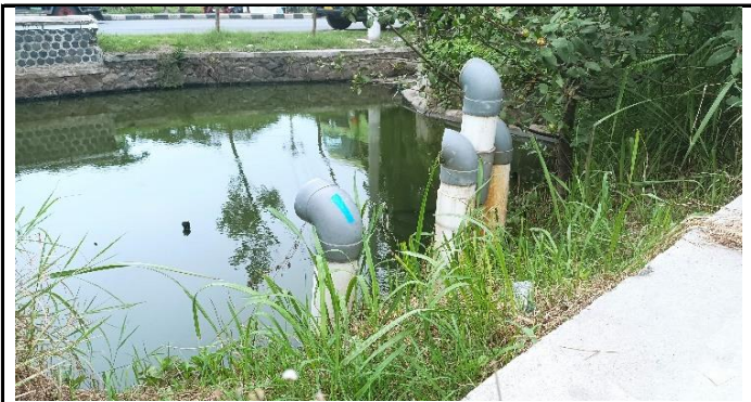
PIPA UNTUK MENGALIRKAN AIR SUNGAI DARI POMPA
