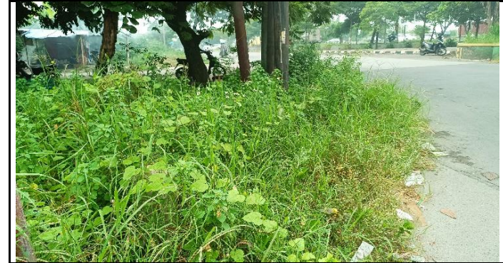
JEMBATAN DITUMBUHI SEMAK BELUKAR
