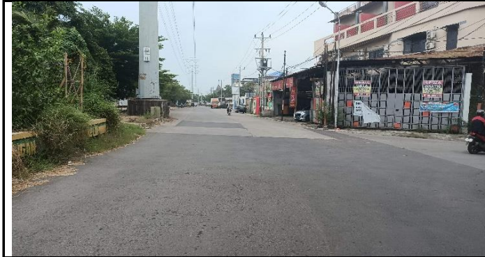
LAPIS PERMUKAAN LANTAI TIDAK SAMA TINGGI
