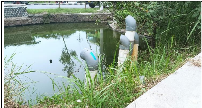
PIPA UNTUK MENGALIRKAN AIR SUNGAI DARI POMPA
