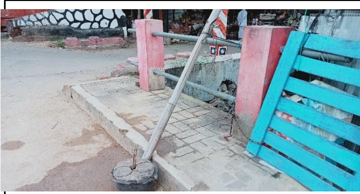
KONDISI TROTOA DAN SANDARAN
