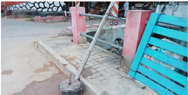
KONDISI SANDARAN DAN TROTOAR
