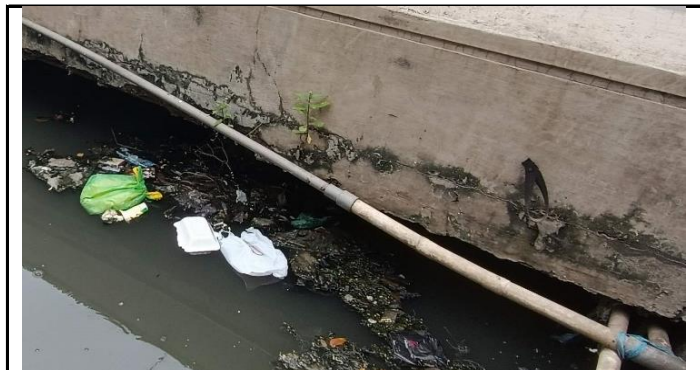
KERETAKAN PADA PELAT JEMBATAN
