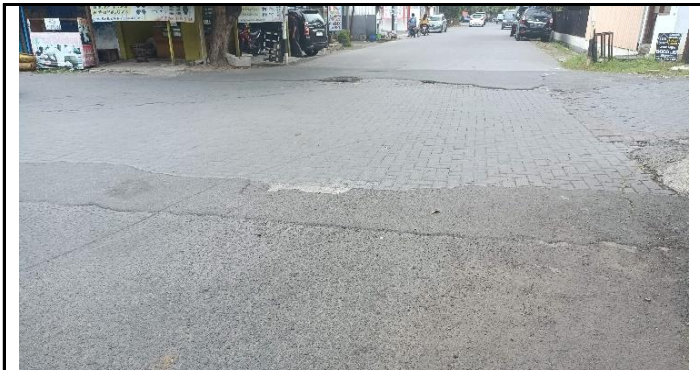
JALAN PENDEKAT BERLUBANG
