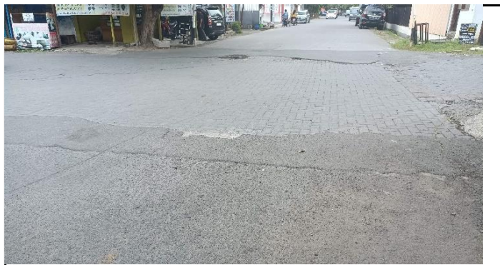
JALAN PENDEKAT BERLUBANG
