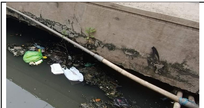
KERETAKAN PADA PELAT JEMBATAN
