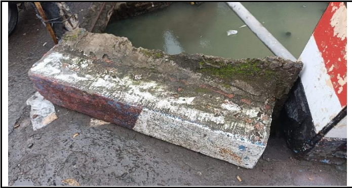
TEMBOK SEDADA RUNTUH
