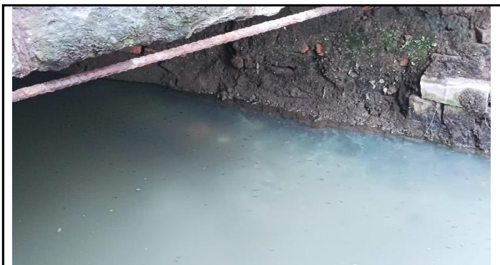
KEPALA JEMBATAN MENGALAMI KERONTOKAN ELEMEN
