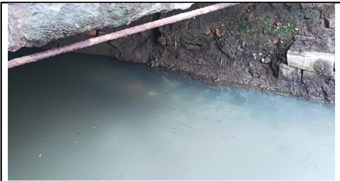
KEPALA JEMBATAN MENGALAMI KERONTOKAN ELEMEN
