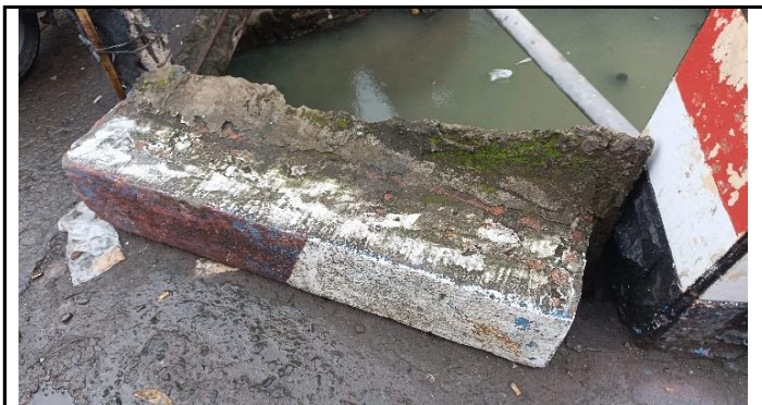
TEMBOK SEDADA RUNTUH
