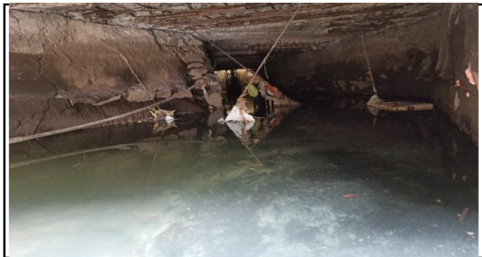
KONDISI BANGUNAN BAWAH JEMBATAN
