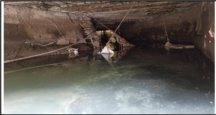
KONDISI BANGUNAN BAWAH JEMBATAN
