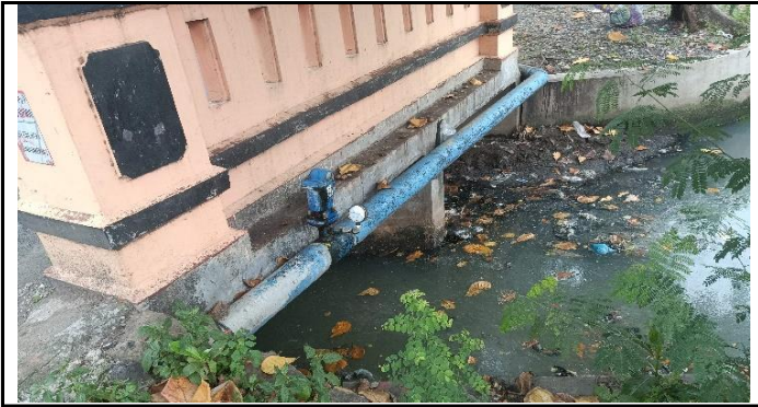
SEDIMENTASI SUNGAI PADA BAWAH JEMBATAN
