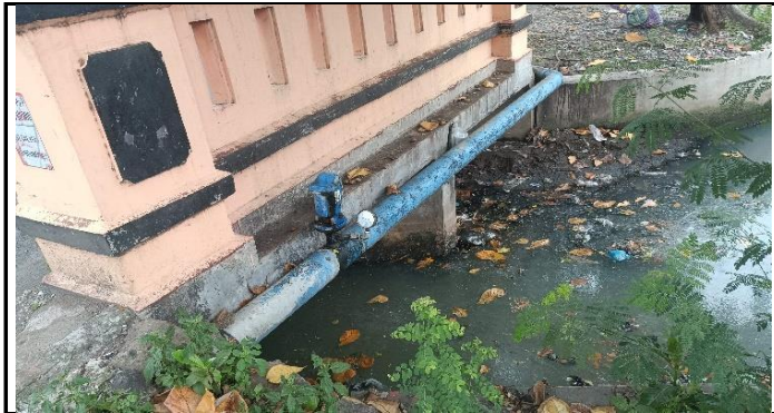
SEDIMENTASI SUNGAI PADA BAWAH JEMBATAN
