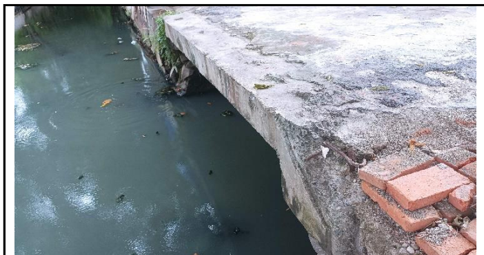
PELAT JEMBATAN RETAK
