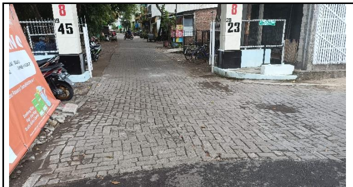
JALAN PENDEKAT BERGELOMBANG
