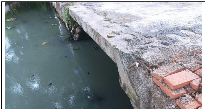
PELAT JEMBATAN RETAK
