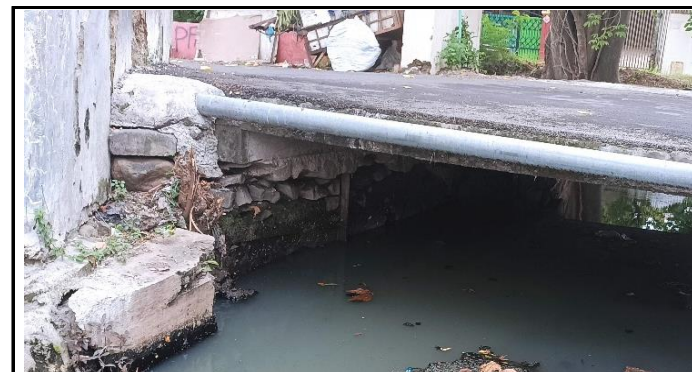
KEPALA JEMBATAN MENGALAMI PENURUNAN MUTU BATU DAN BETON
