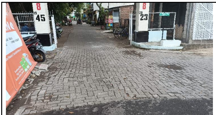
JALAN PENDEKAT BERGELOMBANG
