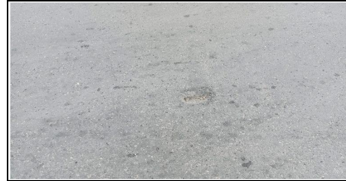
LAPISAN PERMUKAAN LANTAI BERLUBANG
