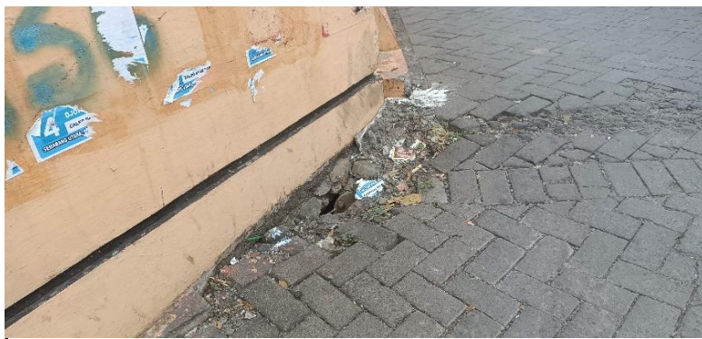
PERKERASAN JALAN PENDEKAT BERLUBANG
