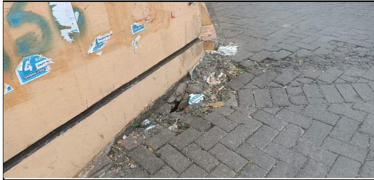
PERKERASAN JALAN PENDEKAT BERLUBANG
