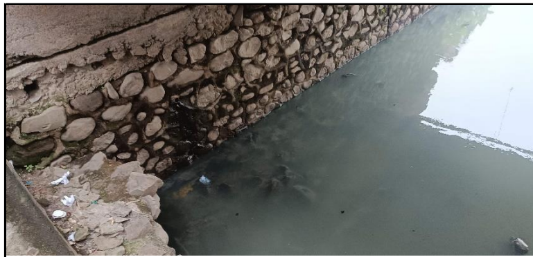
PENURUNAN MUTU BETON PADA KEPALA JEMBATAN
