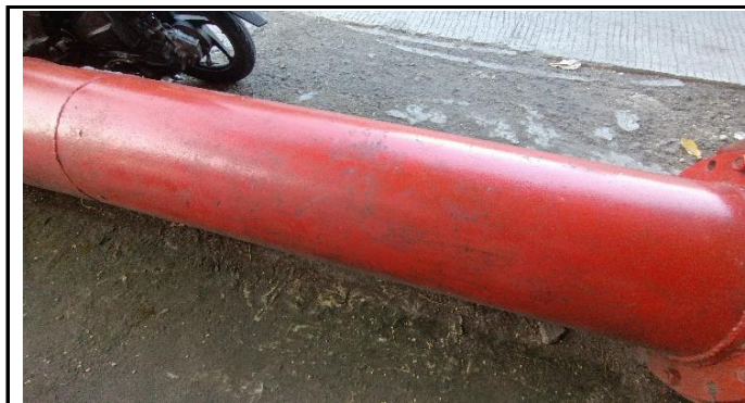
KONDISI UTILITAS PIPA AIR MINUM
