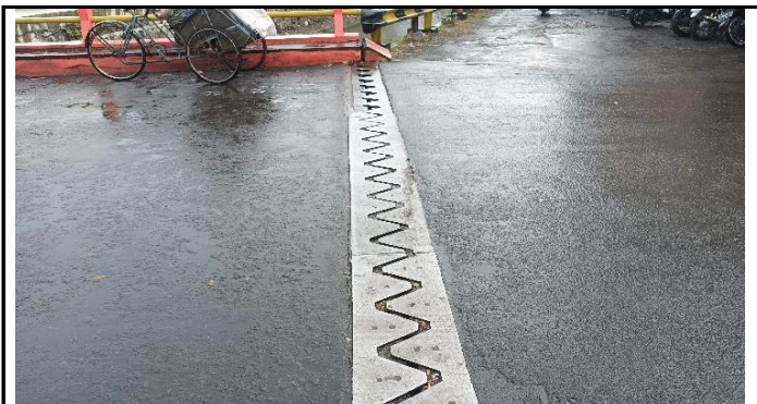
KONDISI SAMBUNGAN SIAR MUAI
