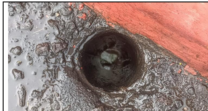
KONDISI PIPA CUCURAN DRAINASE
