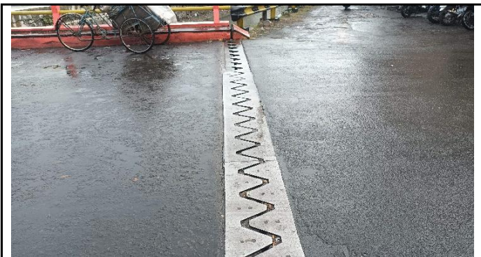
KONDISI SAMBUNGAN SIAR MUAI
