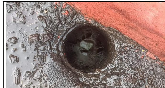
KONDISI PIPA CUCURAN DRAINASE
