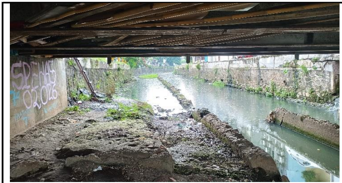
KEPALA JEMBATAN PECAH PADA BETON
