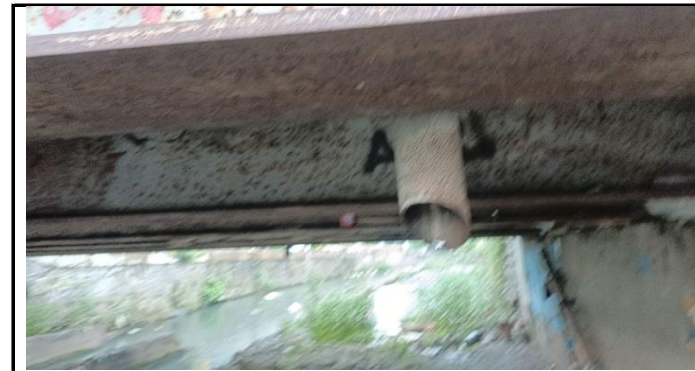
KONDISI PIPA CUCURAN DRAINASE
