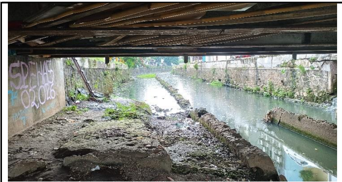
KERUSAKAN PADA BANGUNAN PENGAMAN ALIRAN SUNGAI
