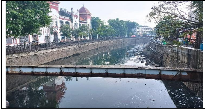
KONDISI TROTOAR DAN SANDARAN
