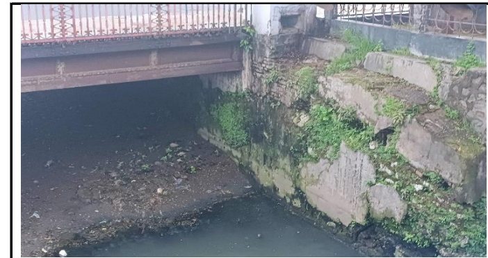
KONDISI KEPALA JEMBATAN DAN TEBING
