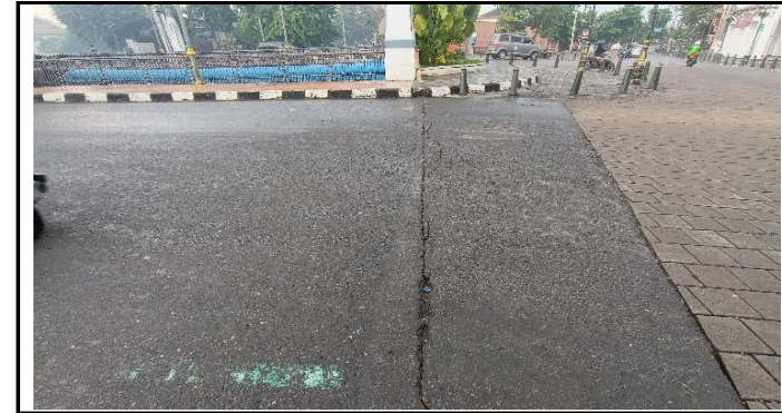
KONDISI SAMBUNGAN ASPAL JEMBATAN
