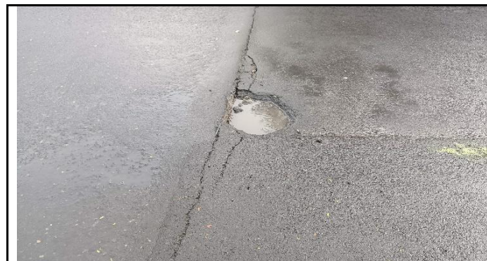
LAPISAN PERMUKAAN LANTAI BERLUBANG
