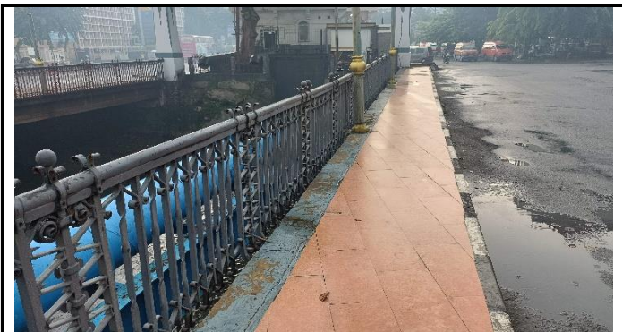
KONDISI TROTOAR DAN SANDARAN
