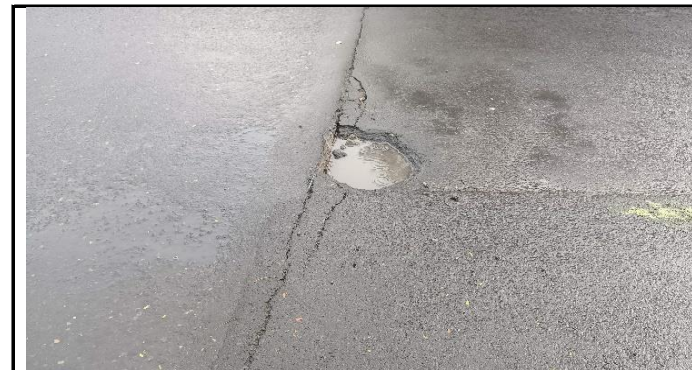
LAPISAN PERMUKAAN LANTAI BERLUBANG
