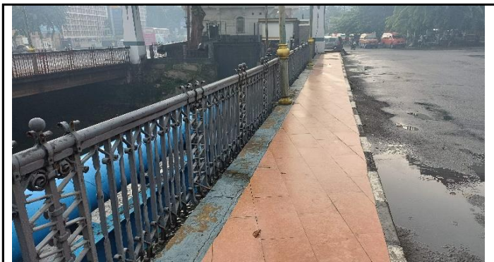
KONDISI TROTOAR DAN SANDARAN
