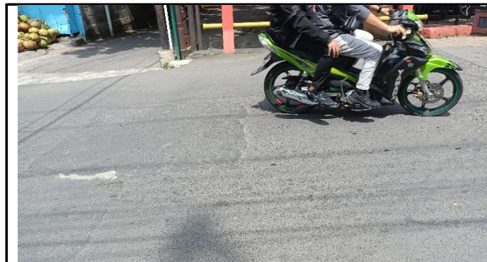
LAPISAN PERMUKAAN LANTAI BERGELOMBANG
