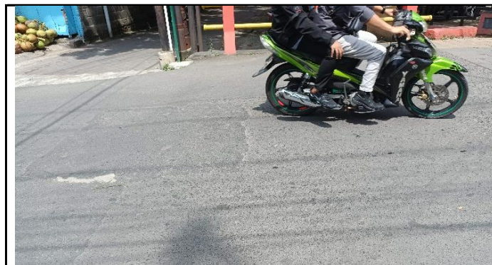
LAPISAN PERMUKAAN LANTAI BERGELOMBANG
