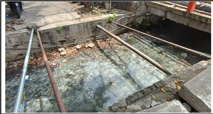
KONDISI UTILITAS PIPA BERKARAT
