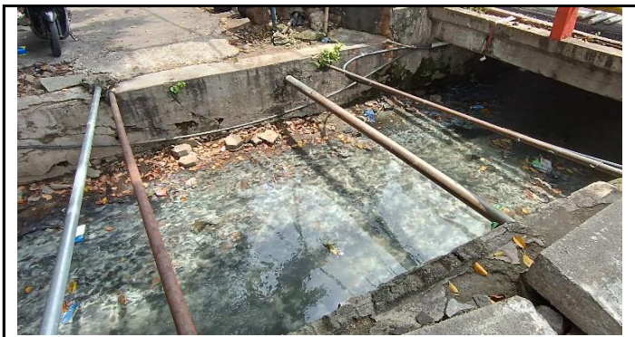
KONDISI UTILITAS PIPA BERKARAT
