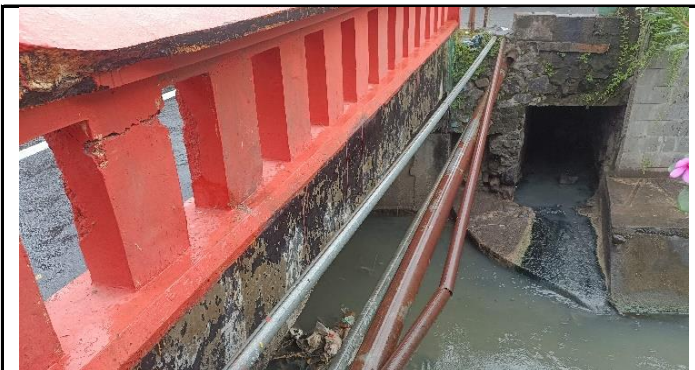
UTILITAS PIPA BERKARAT
