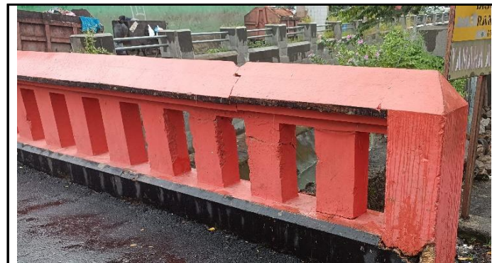
SANDARAN JEMBATAN RETAK
