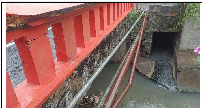
UTILITAS PIPA BERKARAT
