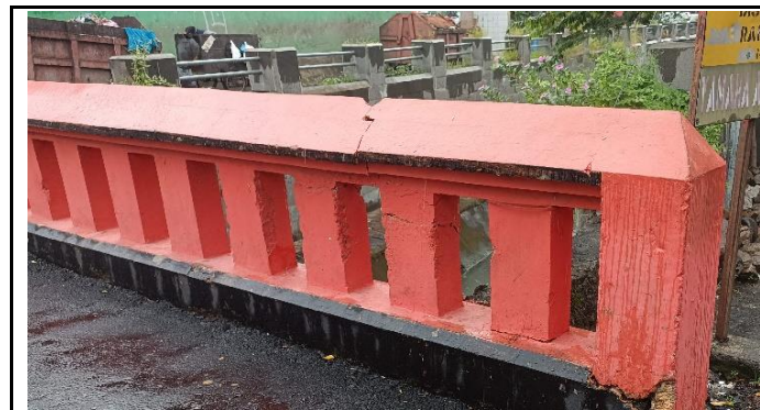
SANDARAN JEMBATAN RETAK
