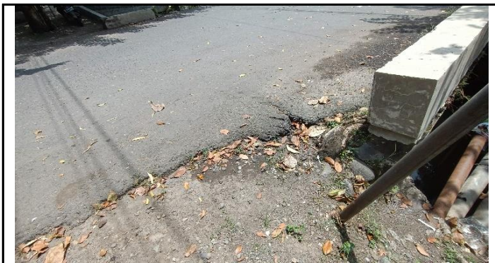
RETAK PADA LAPISAN PERMUKAAN LANTAI
