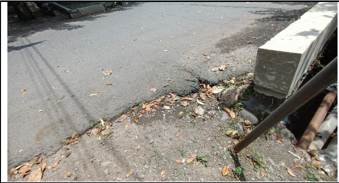
RETAK PADA LAPISAN PERMUKAAN LANTAI
