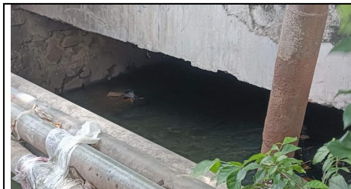
KEPALA JEMBATAN MENGALAMI PENURUNAN MUTU BETON
