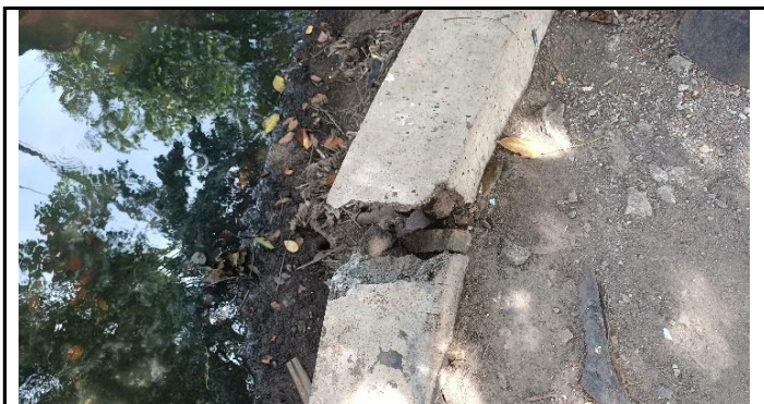
TEMBOK SEDADA PECAH
