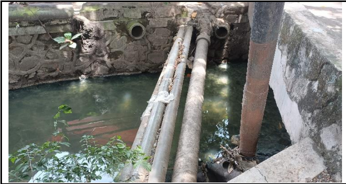
UTILITAS PIPA AIR MINUM BERKARAT
