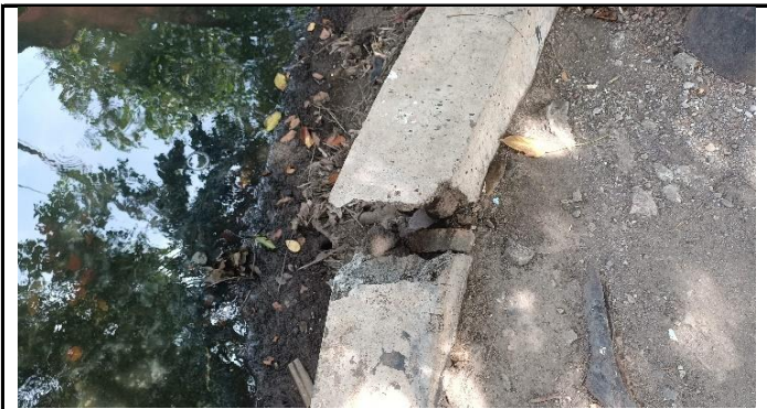
TEMBOK SEDADA PECAH
