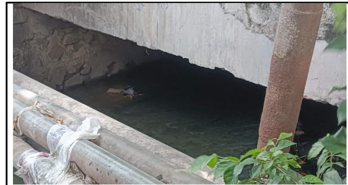
KEPALA JEMBATAN MENGALAMI PENURUNAN MUTU BETON
