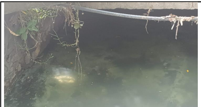
KEPALA JEMBATAN MENGALAMI PENURUNAN MUTU
