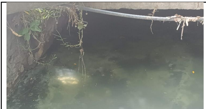
KEPALA JEMBATAN MENGALAMI PENURUNAN MUTU
