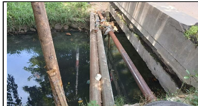
UTILITAS PIPA AIR MINUM BERKARAT
