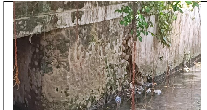
RETAK PADA DINDING PENAHAN TANAH
