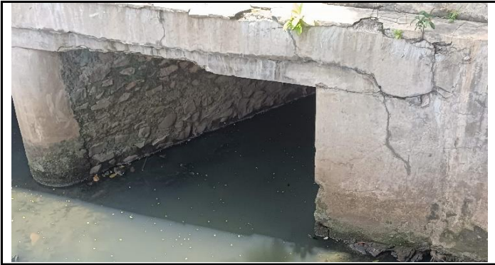
RETAK PADA KEPALA JEMBATAN
