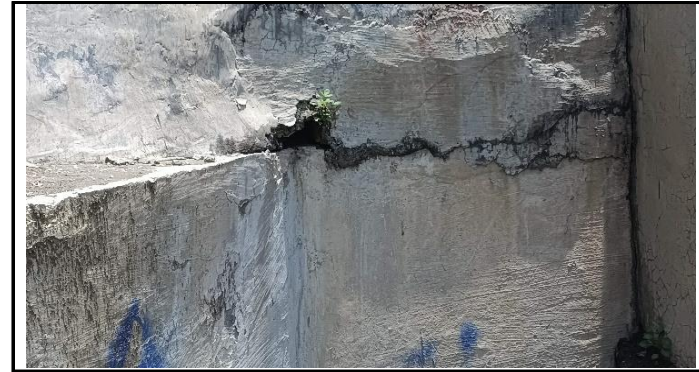
RETAK PADA PELAT
