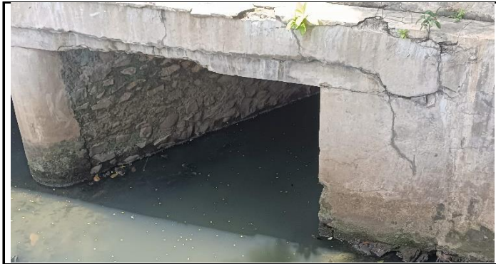
RETAK PADA KEPALA JEMBATAN
