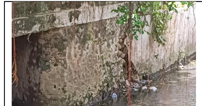
RETAK PADA DINDING PENAHAN TANAH
