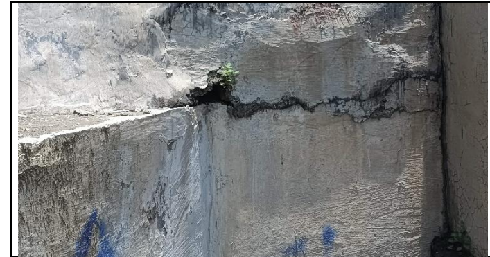
RETAK PADA PELAT
