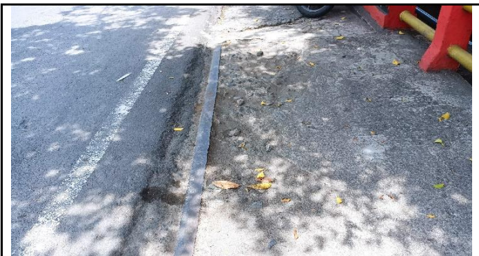
KERUSAKAN PADA TROTOAR
