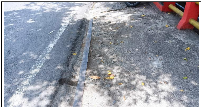
KERUSAKAN PADA TROTOAR
