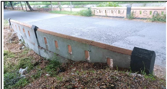
KERETAKAN PADA SANDARAN
