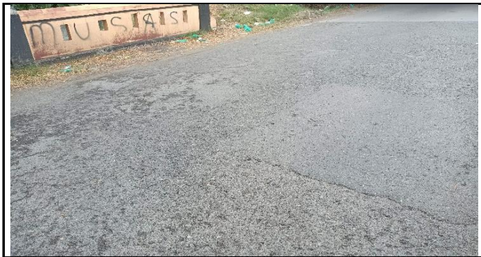
LAPISAN PERMUKAAN JALAN BERGELOMBANG
