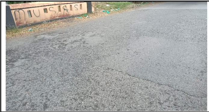
LAPISAN PERMUKAAN JALAN BERGELOMBANG
