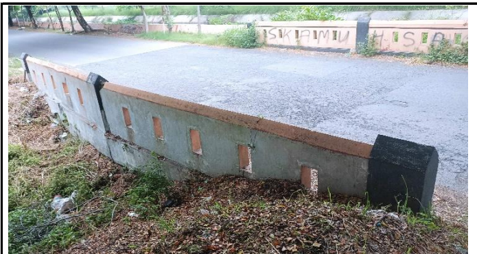
KERETAKAN PADA SANDARAN
