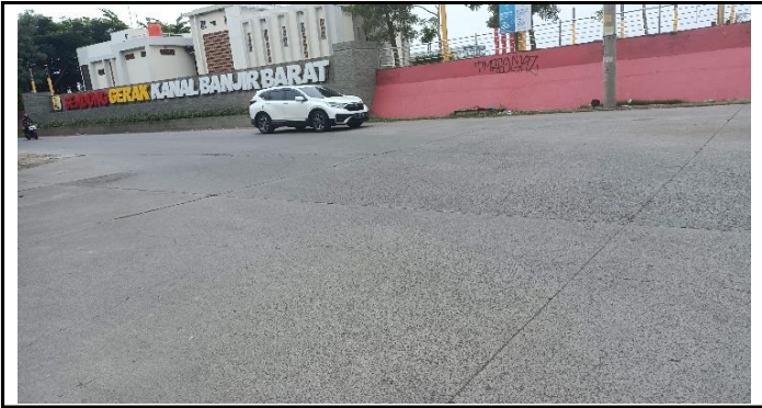
LANTAI PERMUKAAN RETAK MEMANJANG
