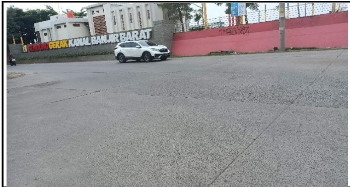
LANTAI PERMUKAAN RETAK MEMANJANG
