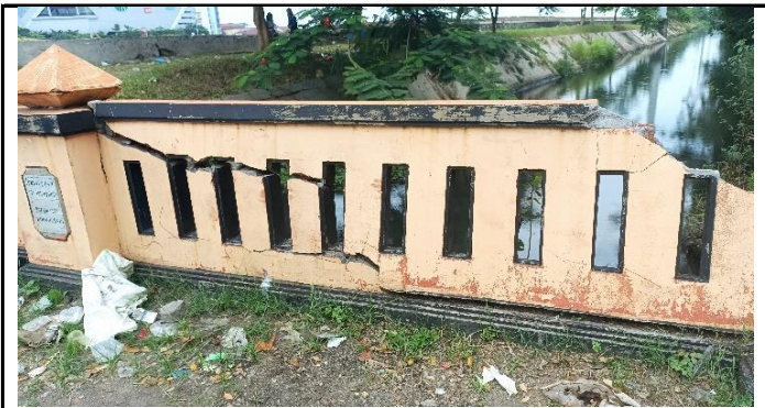
SANDARAN JEMBATAN PECAH
