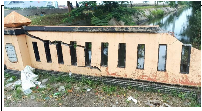
SANDARAN JEMBATAN PECAH
