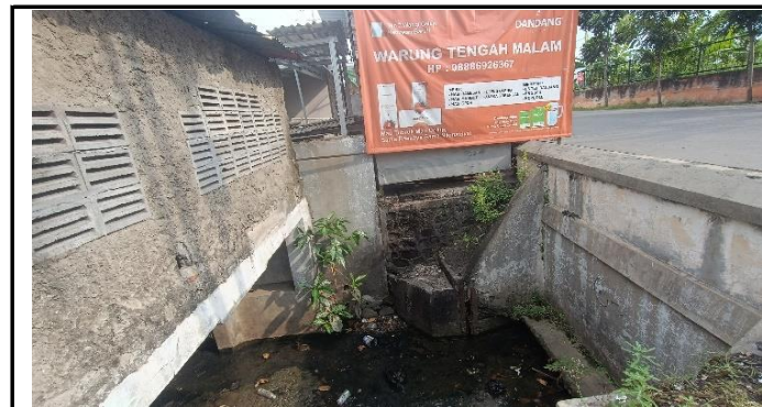
KERONTOKAN BETON PADA TEMBOK SUNGAI
