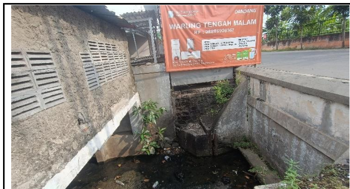
KERONTOKAN BETON PADA TEMBOK SUNGAI
