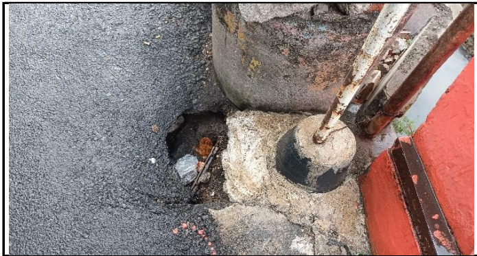
LANTAI JEMBATAN BERLUBANG
