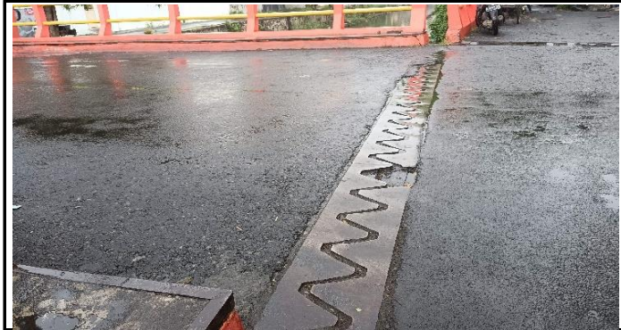
KERUSAKAN PADA SAMBUNGAN SIAR MUAI
