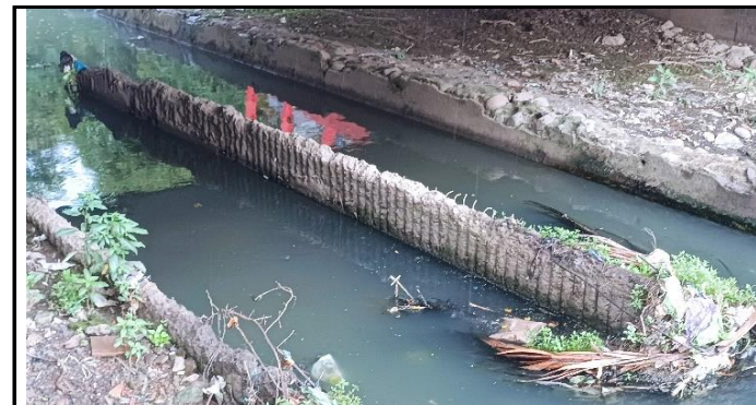
BANGUNAN PENGAMAN ALIRAN SUNGAI MENGALAMI PENGIKISAN
