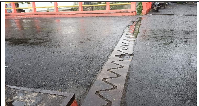
KERUSAKAN PADA SAMBUNGAN SIAR MUAI
