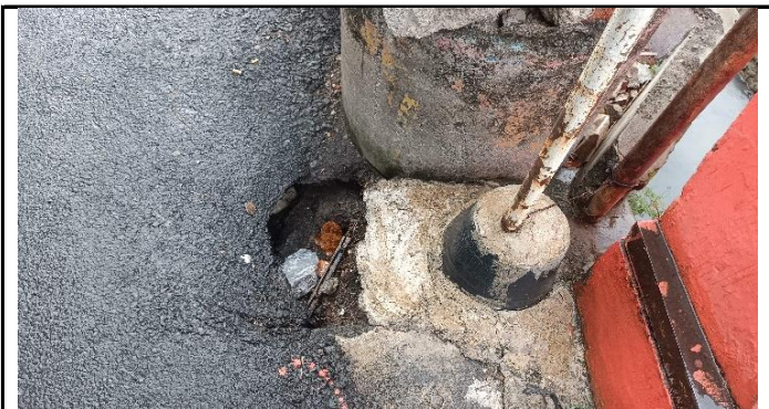
LANTAI JEMBATAN BERLUBANG
