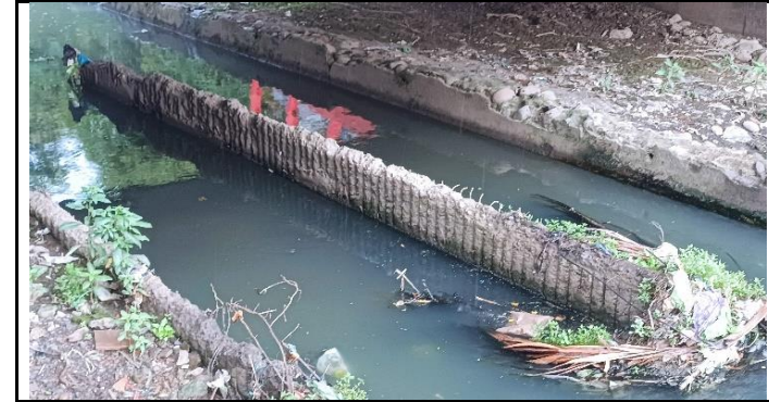
BANGUNAN PENGAMAN ALIRAN SUNGAI MENGALAMI PENGIKISAN
