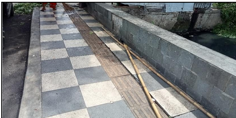
KONDISI TROTOAR DAN SANDARAN
