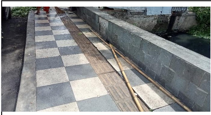
KONDISI TROTOAR DAN SANDARAN
