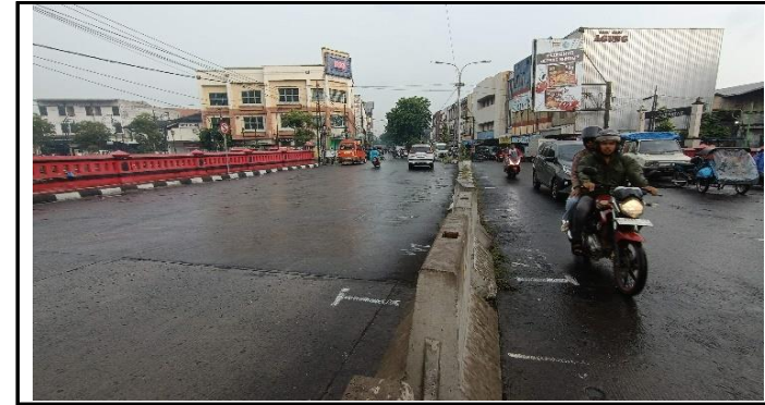
LAPISAN PERMUKAAN LANTAI BERGELOMBANG
