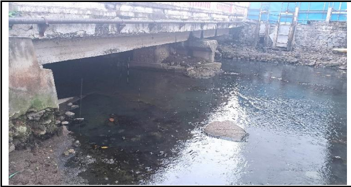
KEPALA JEMBATAN MENGALAMI PENGIKISAN
