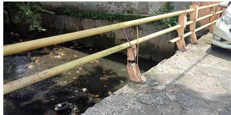
TIANG SANDARAN PECAH
