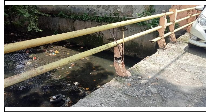
TIANG SANDARAN PECAH
