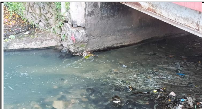
KEPALA JEMBATAN PECAH PADA BETON
