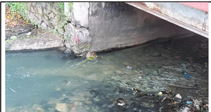
KEPALA JEMBATAN PECAH PADA BETON
