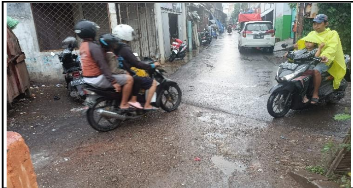
JALAN PENDEKAT BERLUBANG
