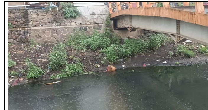
KERUSAKAN PADA TEBING SUNGAI
