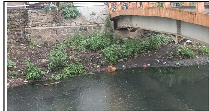
KERUSAKAN PADA TEBING SUNGAI
