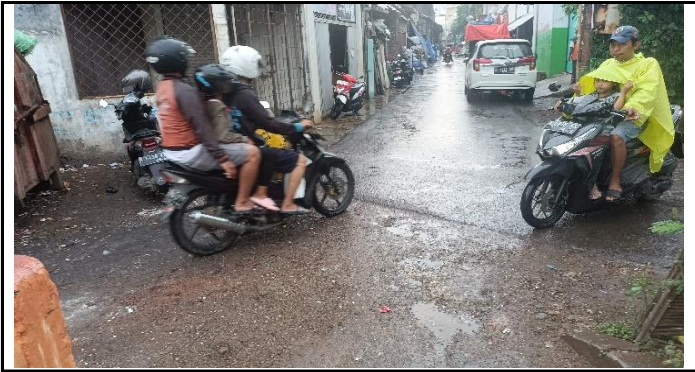
JALAN PENDEKAT BERLUBANG
