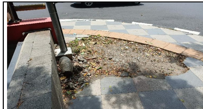
KERUSAKAN PADA TROTOAR
