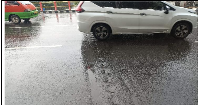
KERUSAKAN PADA EXPANTION JOINT
